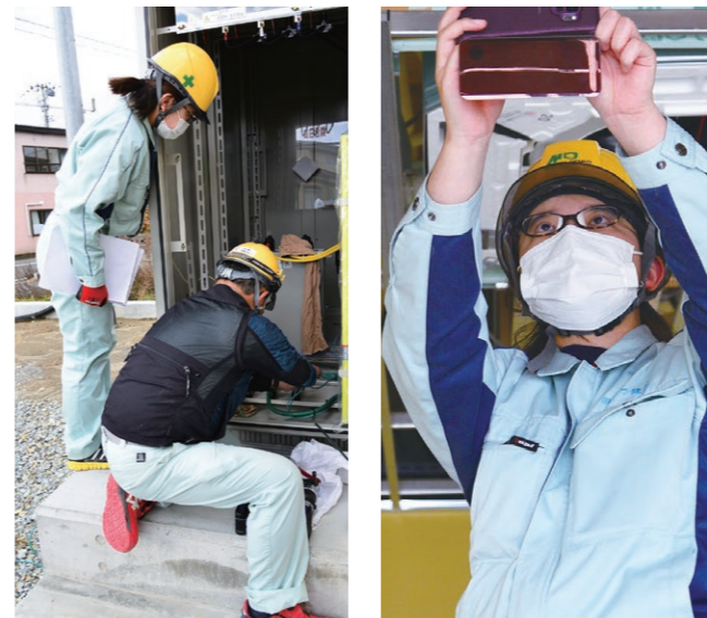
【写真左】キュービクル内の電線接続作業を確認する石田さん(左) 【同右】天井を取り付ける前に、完成した電気設備の写真を撮る石田さん
